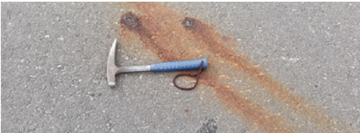
Fig. 5. Aspecte de degradare ale unor sulfuri de fier (pirită și marcasită) din agregatul mixturii asfaltice (foto N. Har)
